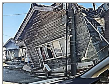
倒壊したままの家屋 👉
